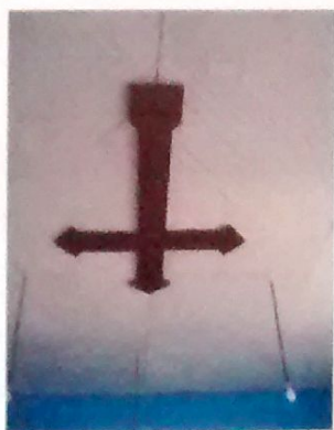
Foto 05- Detalhe do forro Município de São Thomé das Letras – MG Adane Soares Marques | março - 2009
